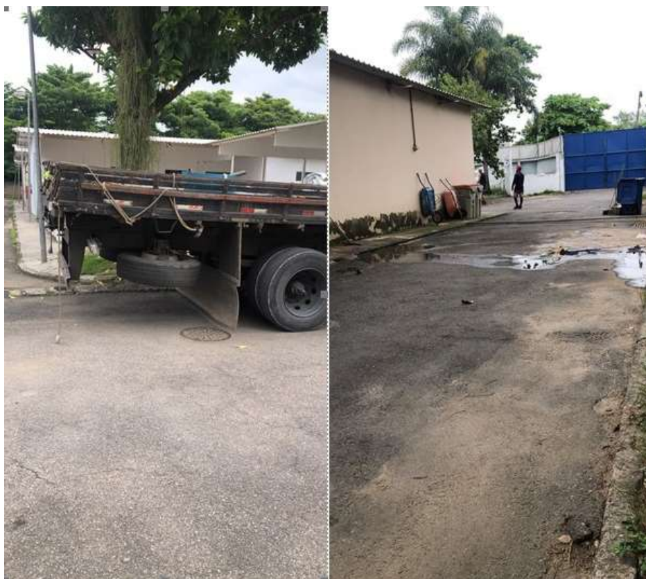
Figura 12. Caminhão aguardando a descarga das ferragens do octanorme (imagem a esquerda), área escolhida para montagem do octanorme (direita).
