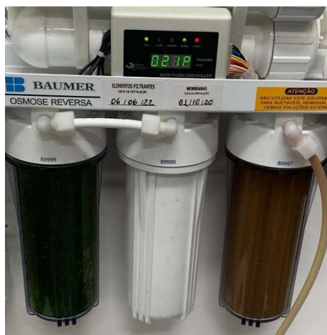
Figura 6 - Filtros de Osmose Reversa - CME
