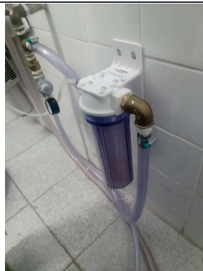
Cavalete de água
