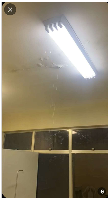
Figura 8 - Vazamento em Sala de Medicação de Felinos
