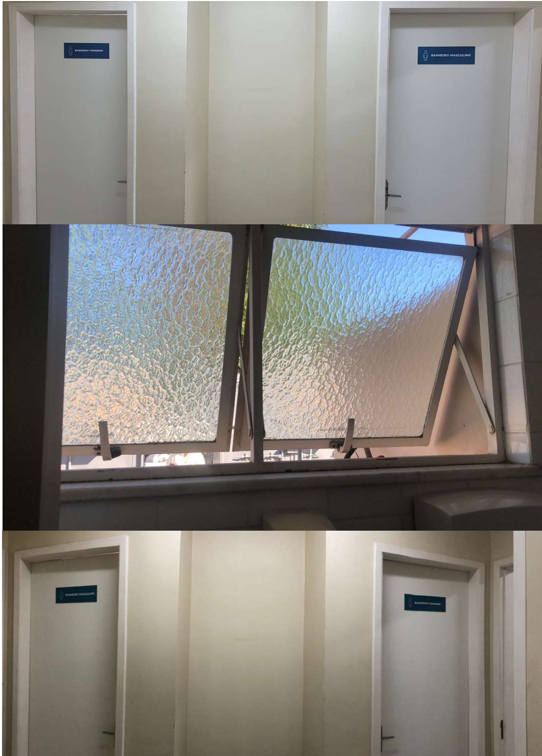
Figura 5. Troca das identificações dos banheiros do bloco cirúrgico devido a exposição do banheiro feminino em decorrência de duas janelas existentes.
