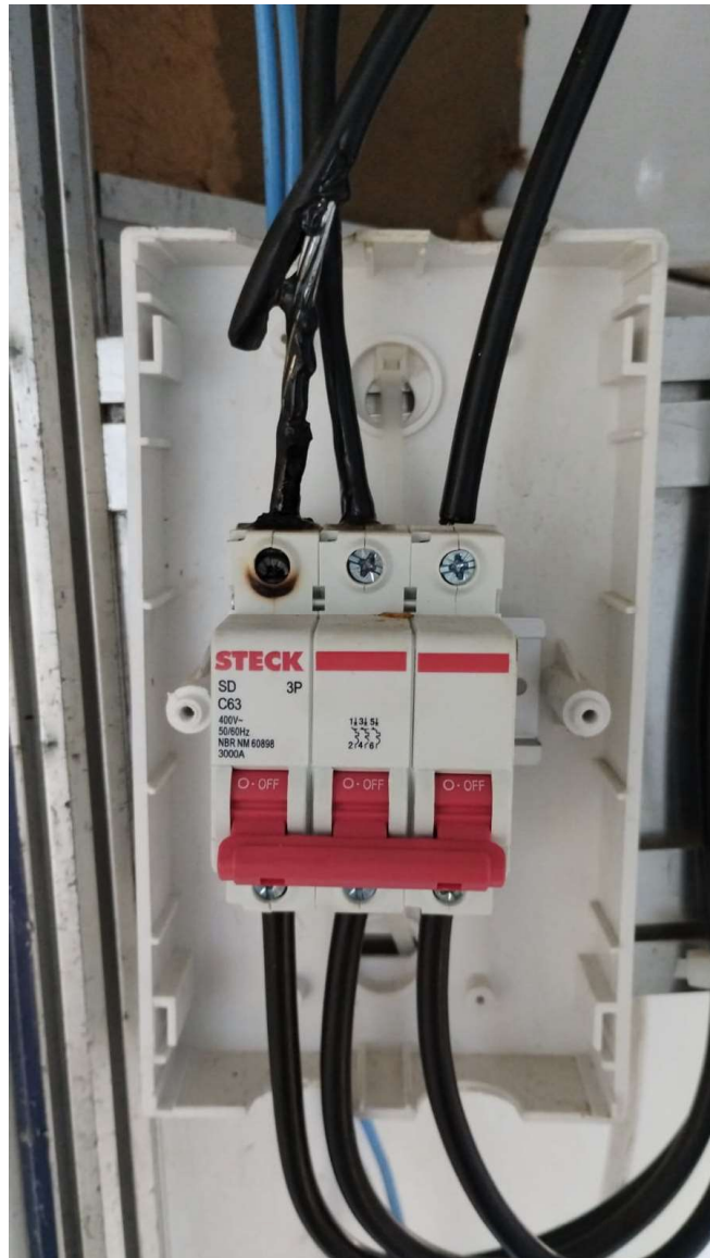
Figura 18 Disjuntor localizado no sistema elétrico do octanorme.
