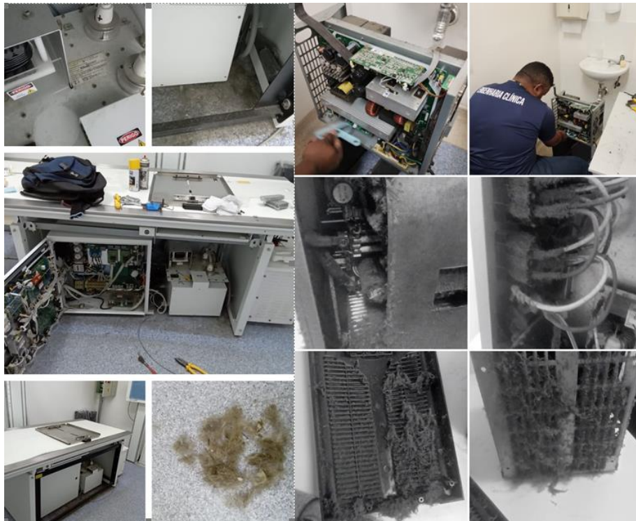
Figura 7. Manutenção preventiva da sala de radiologia.
