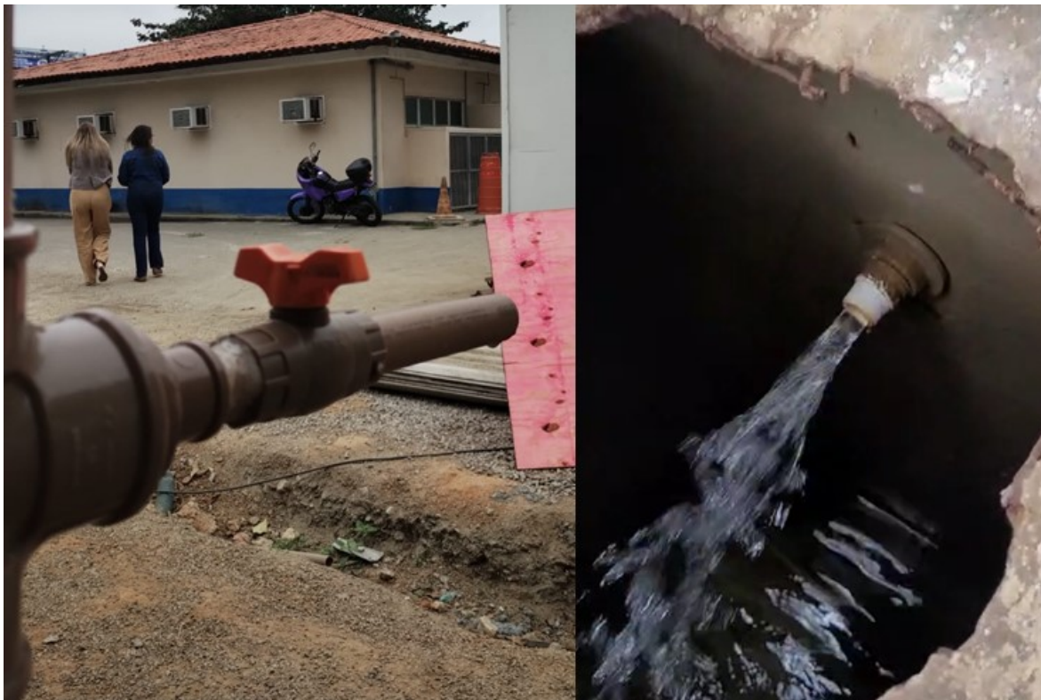
Figura 12. Registro de água criado como alternativa para abastecer o setor de clínica cirúrgica a esquerda. Vazão de abastecimento na cisterna após correção da obstrução do cano.
