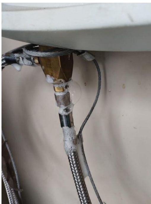
Figura 22. Observação de vazamento na central de gases medicinais que abastece o centro cirúrgico.
