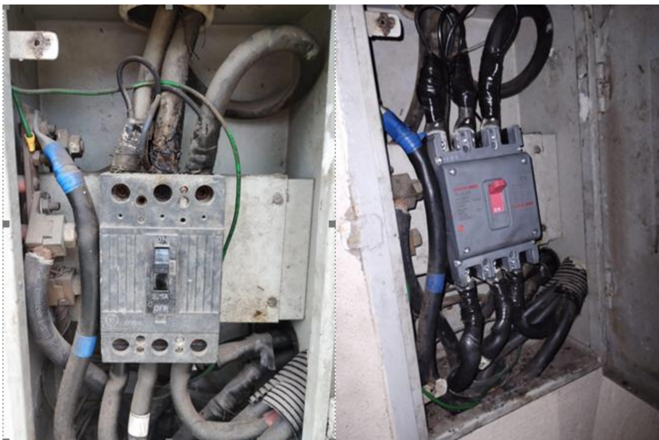
Figura 3. Disjuntor elétrico com defeito (foto a esquerda) e disjuntor novo após a troca do defeituoso (imagem a direita).
