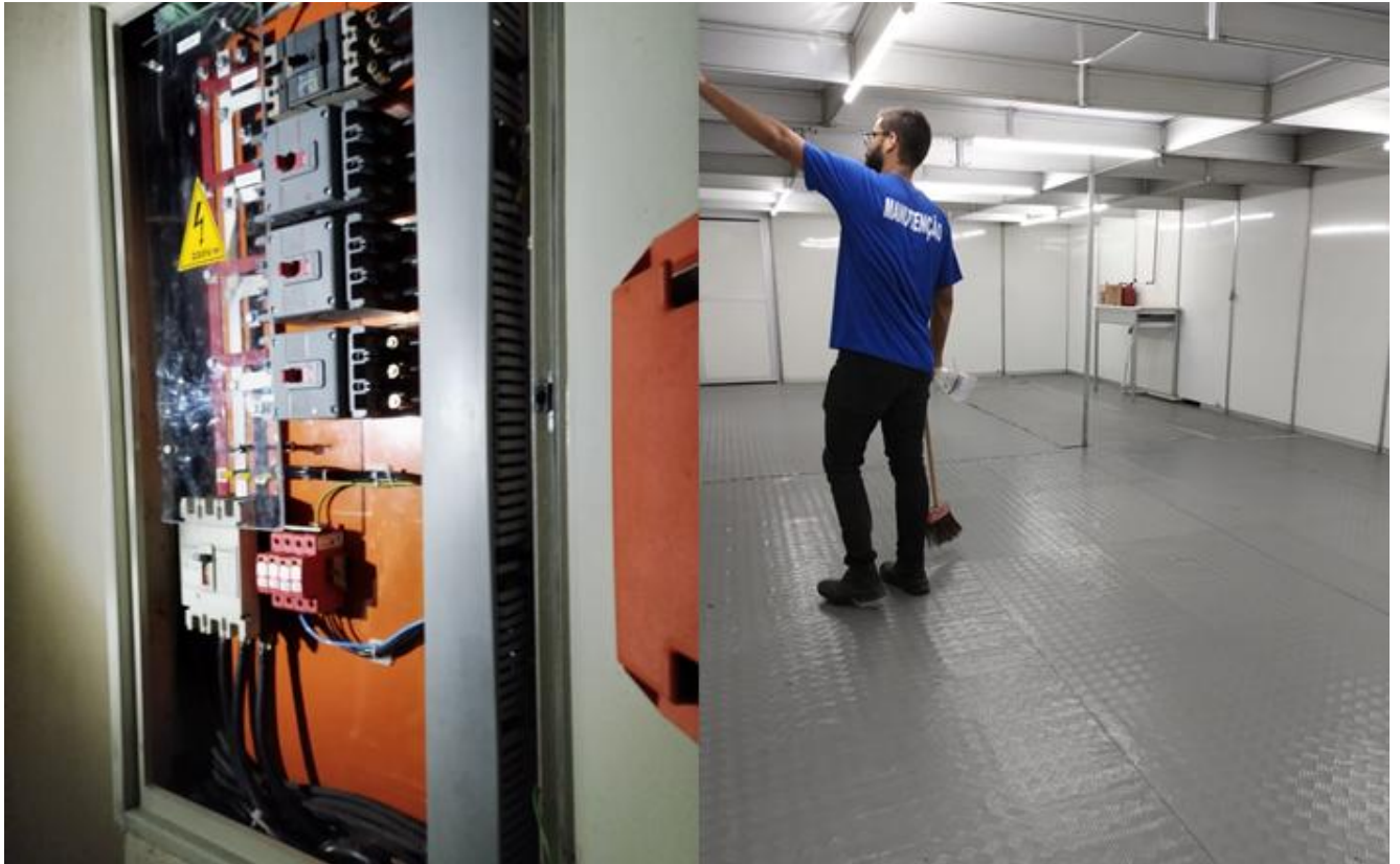
Figura 13. Quadro de energia elétrica (esquerda) e área interna do octanorme.
