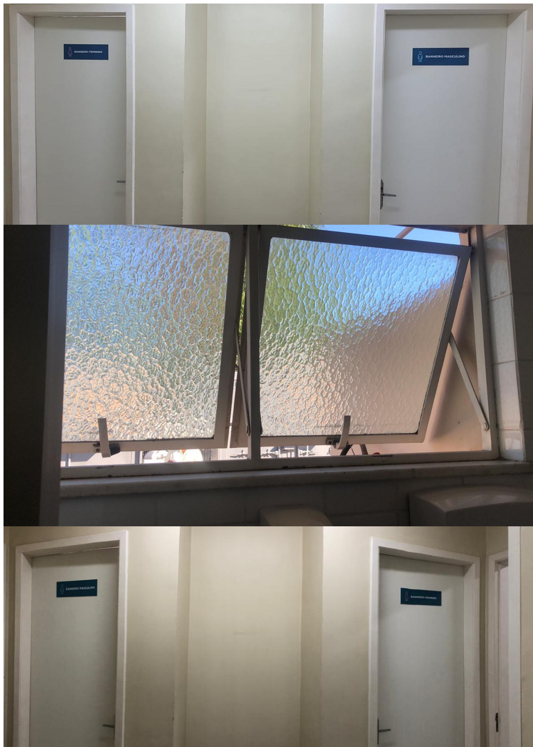
Figura 5. Troca das identificações dos banheiros do bloco cirúrgico devido a exposição do banheiro feminino em decorrência de duas janelas existentes.
