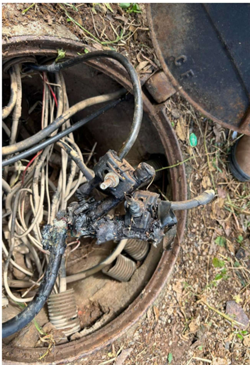
Figura 4. cabo de energia de 120mm, apresentava-se carbonizado.
