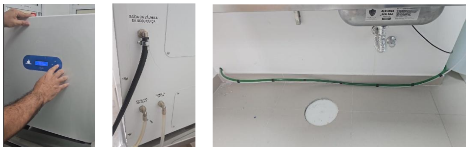
Figuras 25 a 27. Instalação da Autoclave Cristófoli.
