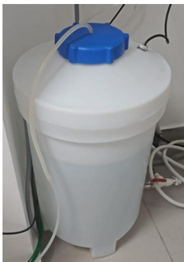
Figura 28. Instalação da mangueira da Autoclave Cristófoli diretamente na Osmose Reversa da CME.
