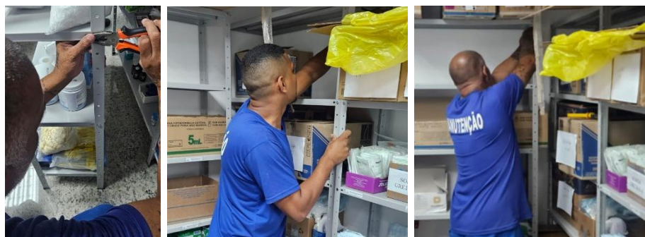
Figuras 17 a 19 – Fixação das Estantes do Almojarifado e da Farmácia do HMVSFA.
