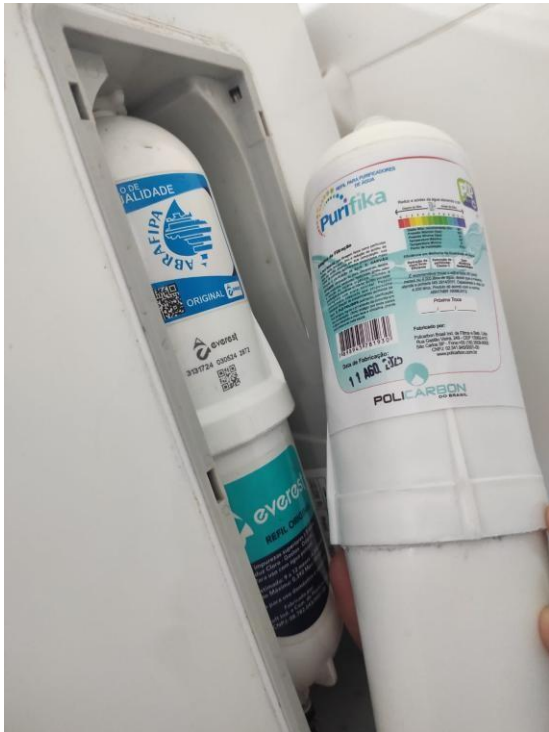
Figura 19. Troca de refil de bebedouro.
