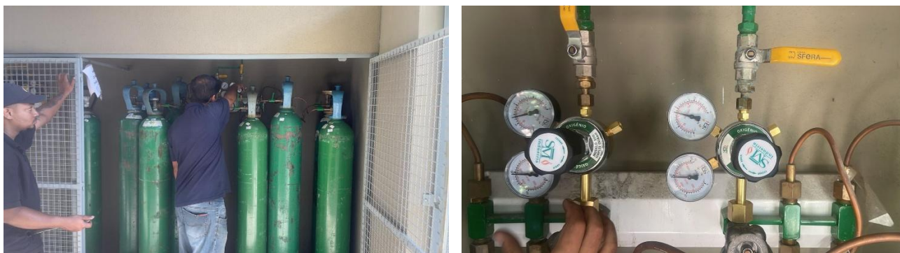
Figuras 19 e 20 – Substituição de 02 (duas) válvulas reguladoras de gás medicinal (oxigênio) da Central de Gases do HMVSFA.
