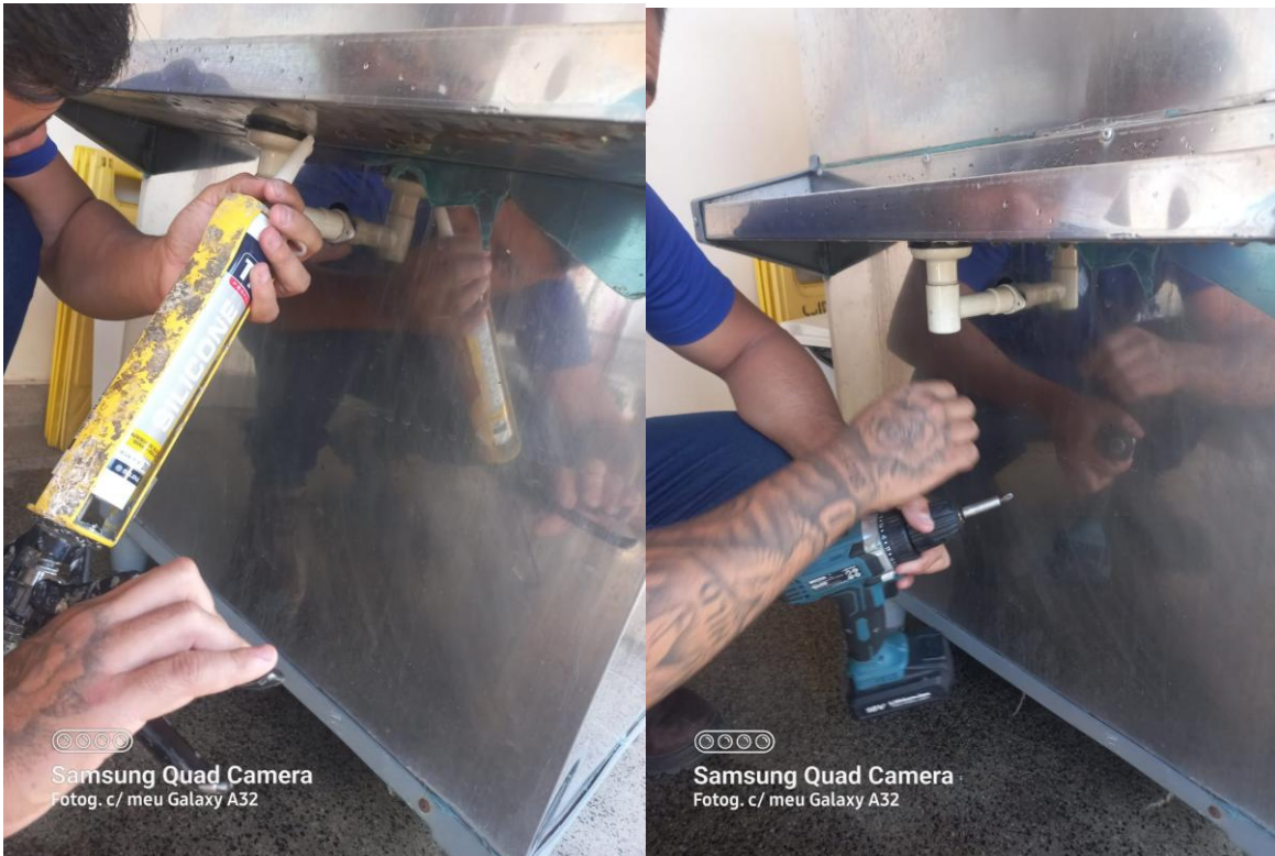
Figura 06. Manutenção do bebedouro externo.
