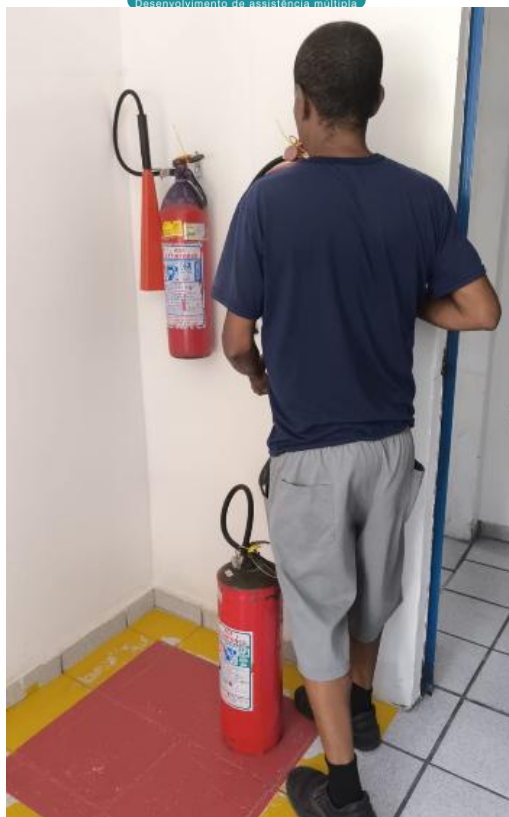
Figura 20 .Em 30/03/26, foi realizada a troca dos extintores no Hospital Municipal Veterinário Jorge Vaitsman, garantindo conformidade com as normas de segurança e a proteção de todos.
